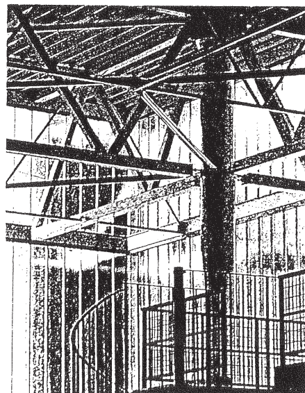
Les treillis en profils creux rectangulaires de la structure du gymnase de Montargis (Eric Dubosc et Marc Landowski, 1990) sont apparents à l'intérieur et à l'extérieur de l'édifice, dont ils traversent l'enveloppe transparente en acier.
